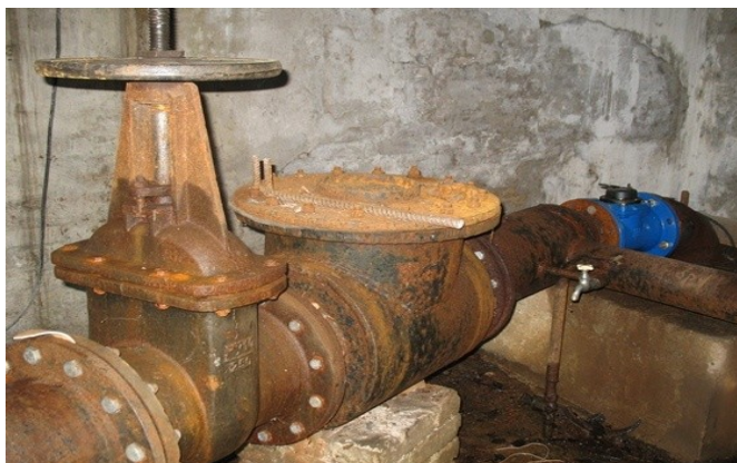
Рисунок 65 – Скважинный подрусловый водозабор
