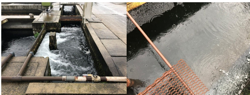
Рисунок 23 – Донные аэрационные сооружения участка №4
