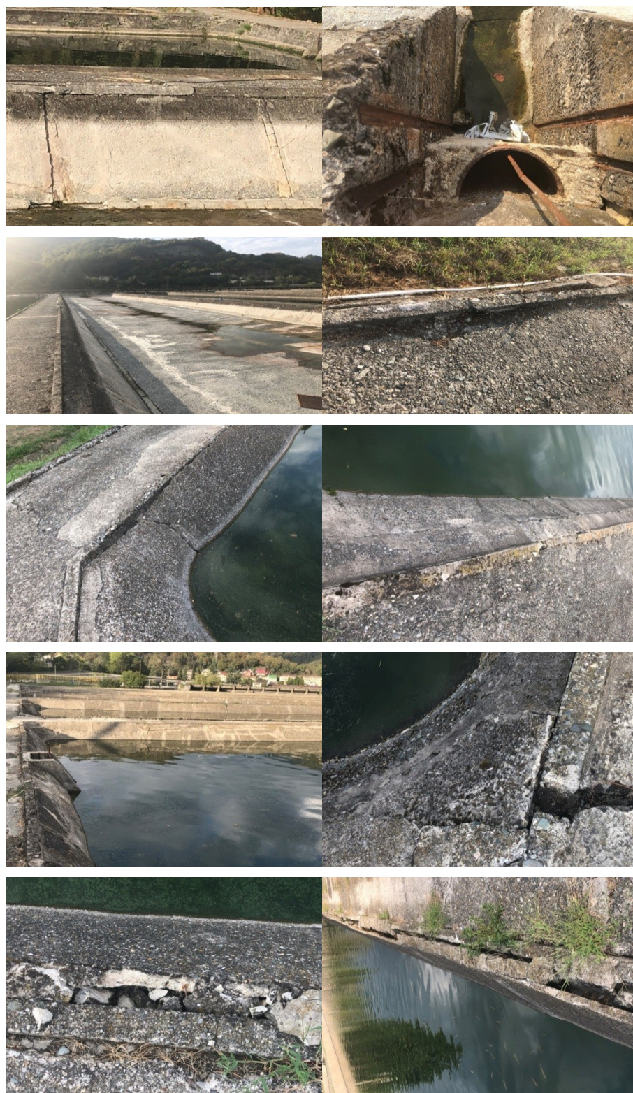
Рисунок 15 – Повреждения конструктивных элементов
