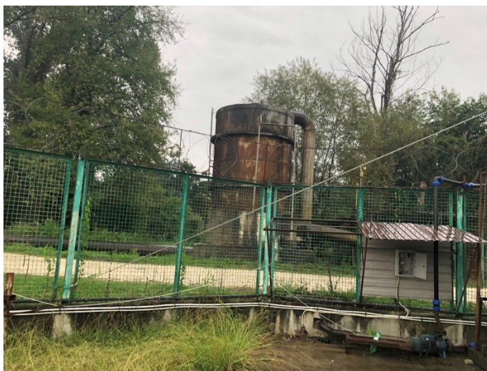
Рисунок 27 - Дегазационная емкость центрального водовода
