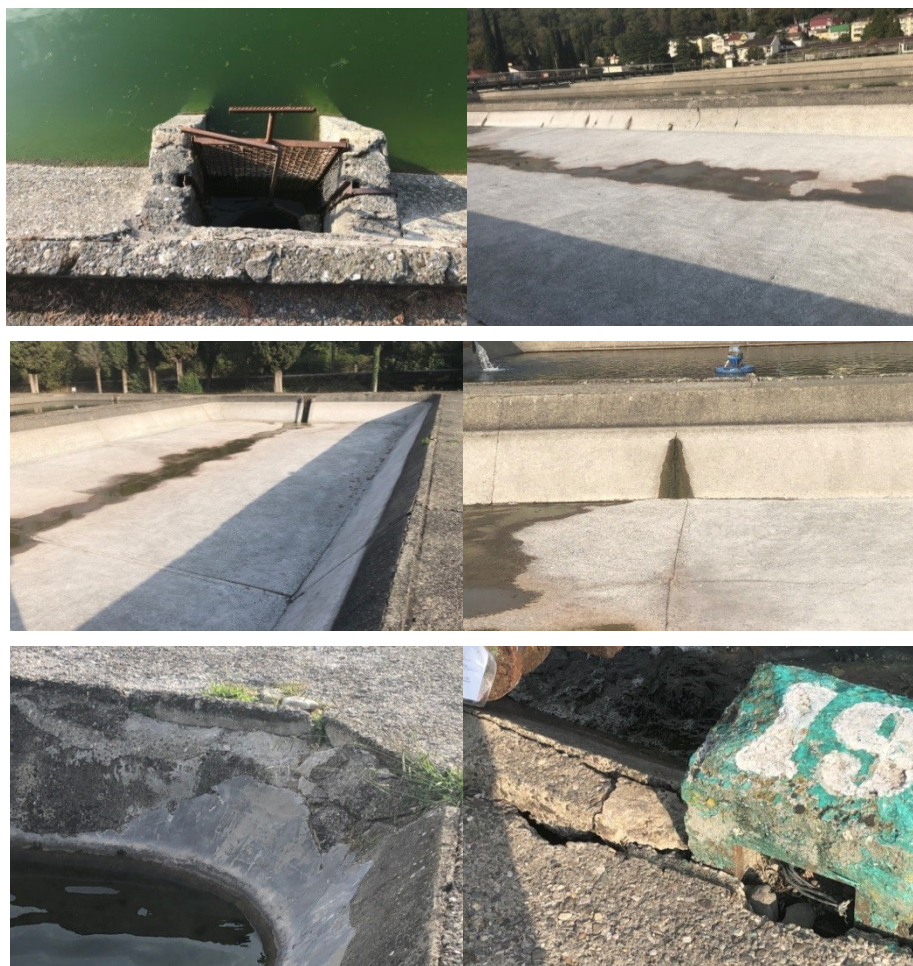
Рисунок 13 – Состояние конструктивных элементов нагульного участка
